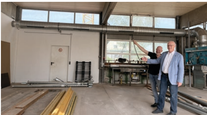
BM Molt und Olaf Berger, Leiter des Bauhofs zeigen das neue Holzdach in der LKW-Halle
